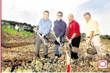
Vier Männer, vier Spaten: Architekt Hans Berger, Uwe Stoll (Brühl GmbH), OB Klaus Mättig und Klaus Böhm (FPE, von links) geben den Startschuss zur Erschließung des Wohngebietes „Birkigter Höhe“. Foto: Thorsten Eckert
